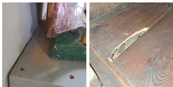
Bilder des Schädlingsbefalls in der Pfarrkirche St. Kilian
